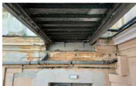
Ante Operam Particolare perdita d'acqua tubazioni di scarico
